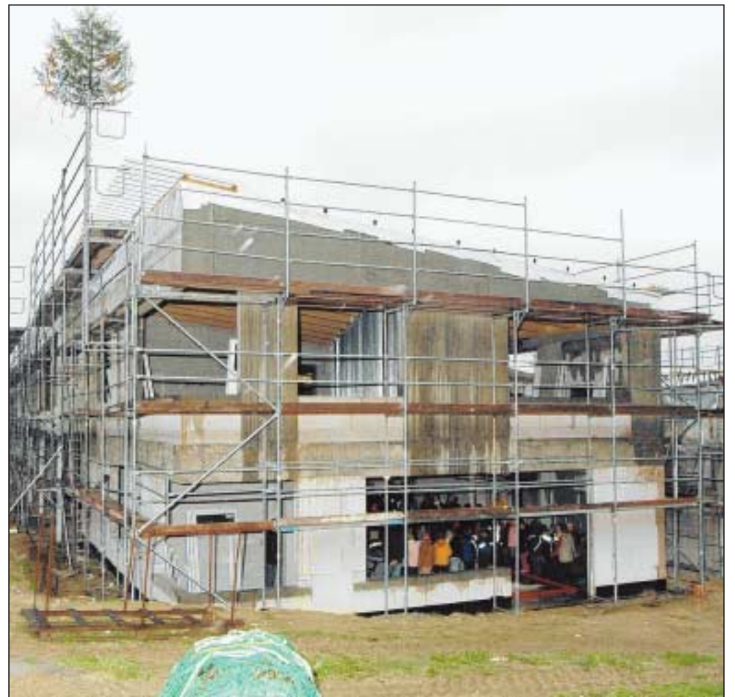
Die Idsteiner Architektengemeinschaft Gerhard Guckes, Axel Schmidt und Iris Thomas haben den Neubau der Grundschule in Bärstadt entworfen. Gestern war Richtfest. Foto: RMB/Kühner
